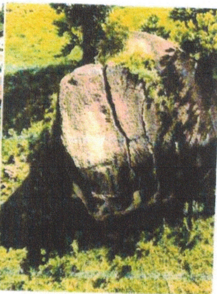
FOTO 06 (DRONE) – Vista parcial superior do bloco rochoso vistoriado onde se observa a presença de vegetação inseridas nas fraturas.
