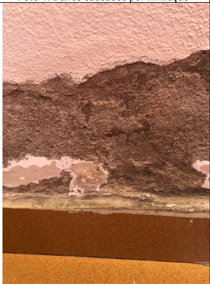
Foto 6. Danos causados por infiltração
