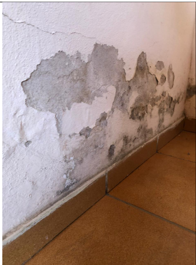
Foto 4. Danos causados por infiltração
