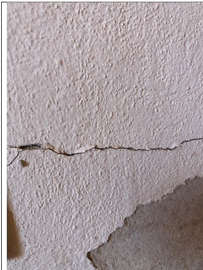
Foto 3. Rachadura na estrutura da casa
